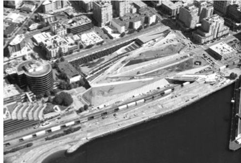
Figura 3: El parque en construcción. Fuente: Graziose, Lisa. Rogers, Chris. 2007. Olympic Sculpture Park, SAM. Seattle EUA, p. 20.
